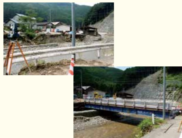
被災直後の中島橋(左)。現在は仮橋として復旧され、利用されている(右)。
